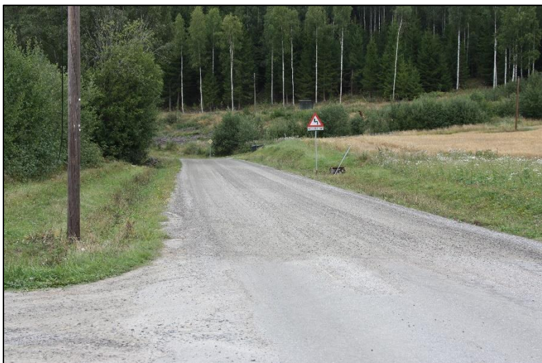
Fra avkjørsel mot nord på fv. 1994. Masten er ikke i bruk.
